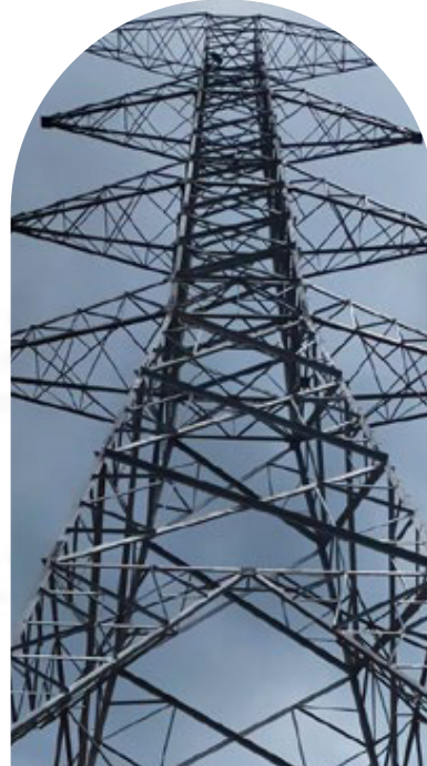
TOWER 500KV SUMATERA SELATAN
