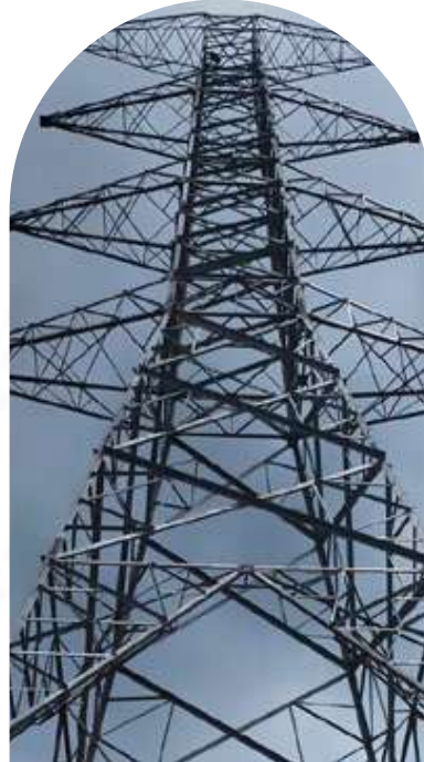
TOWER 500KV SUMATERA SELATAN
